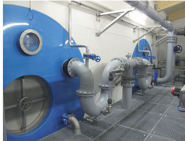
Bild 3: Funktionswände in die Anlagentechnik im Wasserwerk eingebunden
