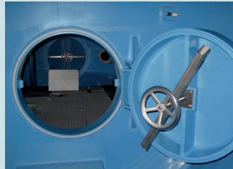
PE-Drucktür mit Blick aus der Wasserkammer in die Armaturenkammer
