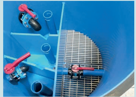
Quellsammelschacht mit 2 Quellzuläufen und Absperrarmaturen
