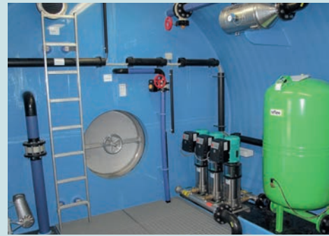
Armaturenkammer mit Druckerhöhungsanlage
